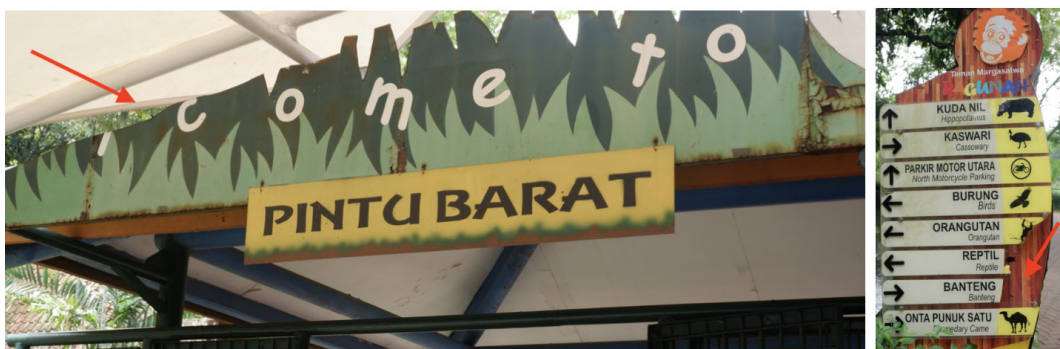
Gambar 2 Kerusakan Pada Signage yang ada di Ragunan. (Sumber: Poerwantoro, 2022)
