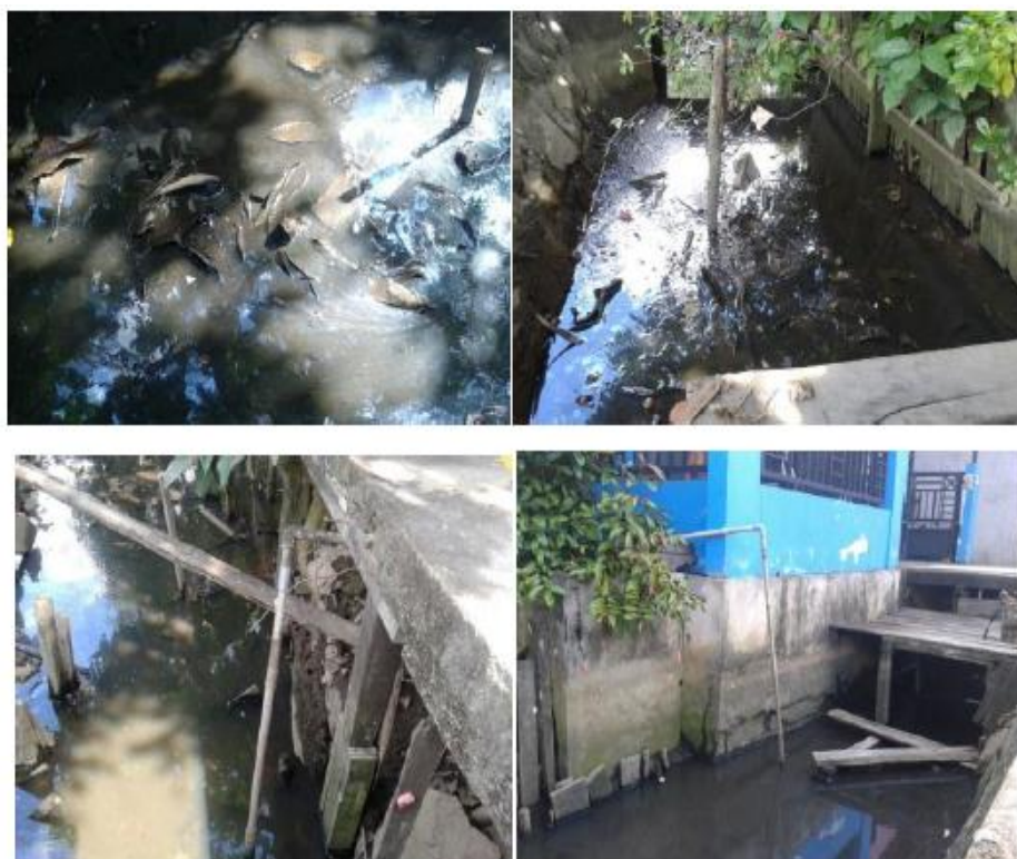
Gambar 1. Kondisi Parit dan Sungai di Lingkungan RT III dan RT IV/RW VIII Kelurahan Tambelan Sampit
