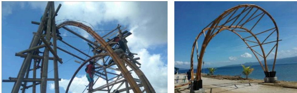
Gambar 6 Proses memasang struktur penguat ( bracing ) pada struktur portal lengkung bambu. (Sumber: Dokumentasi peneliti, 2019)
