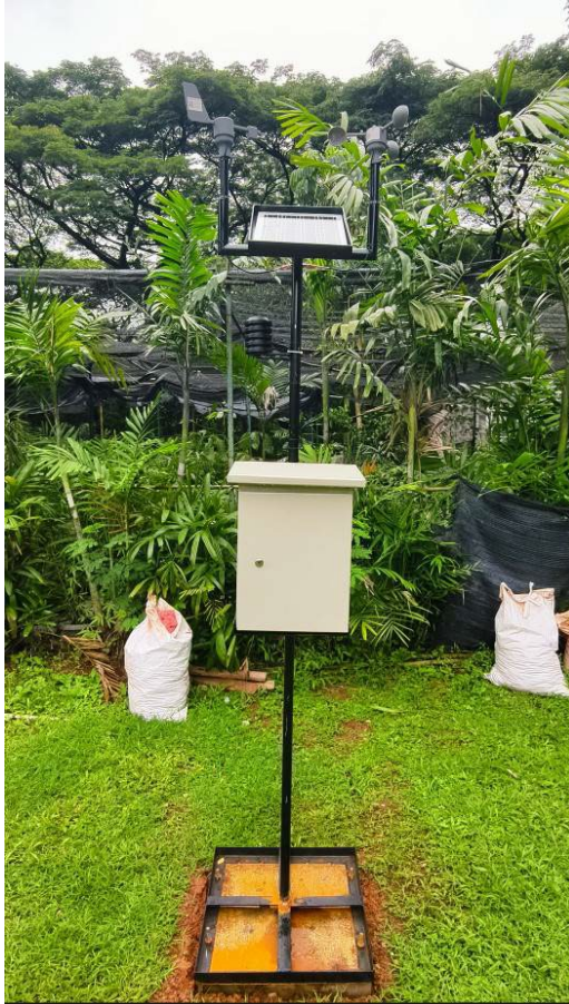
Gambar 5. Kondisi alat di area kampus
